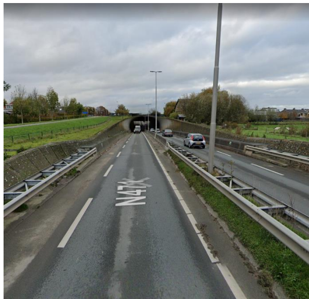
Figuur 199: Toestroom van water wordt over weg richting tunnel geleid
